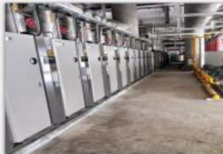
天然氣貫流式鍋爐(18台2.5噸)
